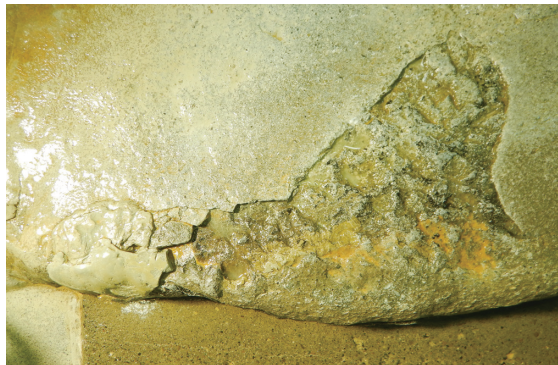
図2. 展示水槽内の床面の割れ
