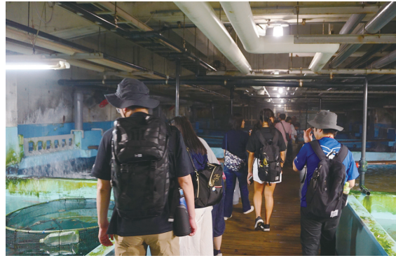
図19. 開館当初から使用している濾過槽
